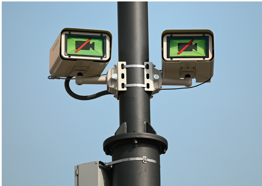
„Datenschutz-Rollo“: An den Kameras sind Jalousien installiert, die die Polizei aus der Ferne herunterfahren kann. Damit ist die Videoüberwachung für Kundgebungsteilnehmer weithin sichtbar deaktiviert. Foto picture alliance/dpa | Arne Dedert
